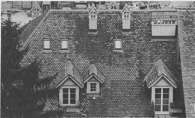
Lebhafte Mischung von Lukarnen (Grösse der Funktion angepasst) und Dachflächenfenstern (in der Grösse an der oberen Grenze)
