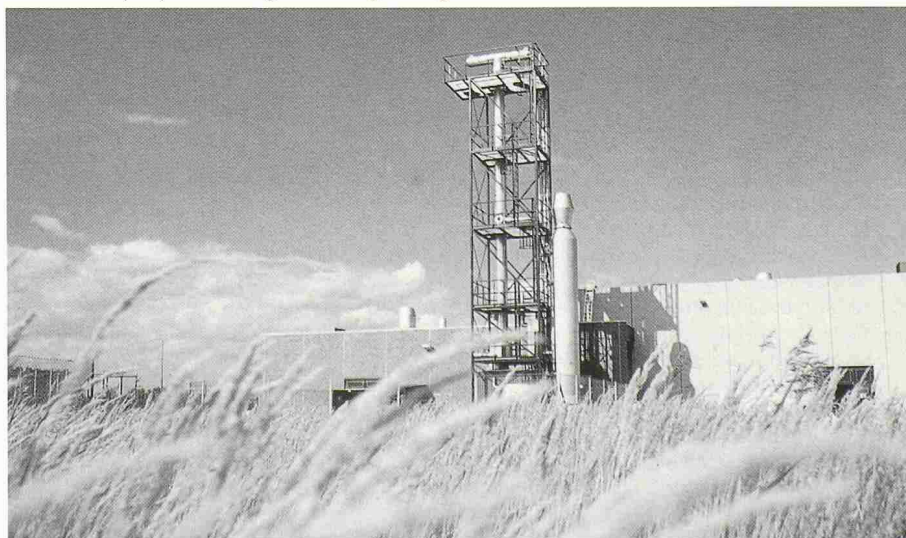
Bild 1. Isopropanolrückgewinnungsanlage für einen Pharmabetrieb
