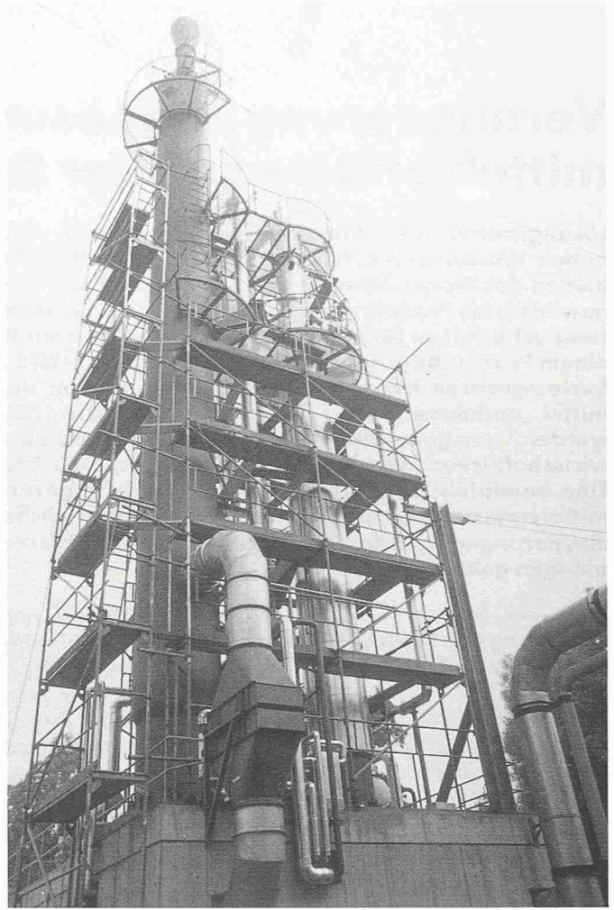
Bild 5. Anlage zur Rückgewinnung von Ethanol und Trichloräthylen aus einem Abluftstrom
