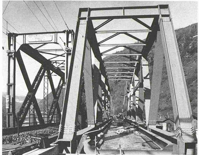
Bild 6. Die alte (links) und die neue Rhonebrücke: die historische Nietkonstruktion mit direkter Schwellenbefestigung neben dem modernen geschweissten, pfostenlosen Dreieckfachwerk in Stahl mit Schottertrog
