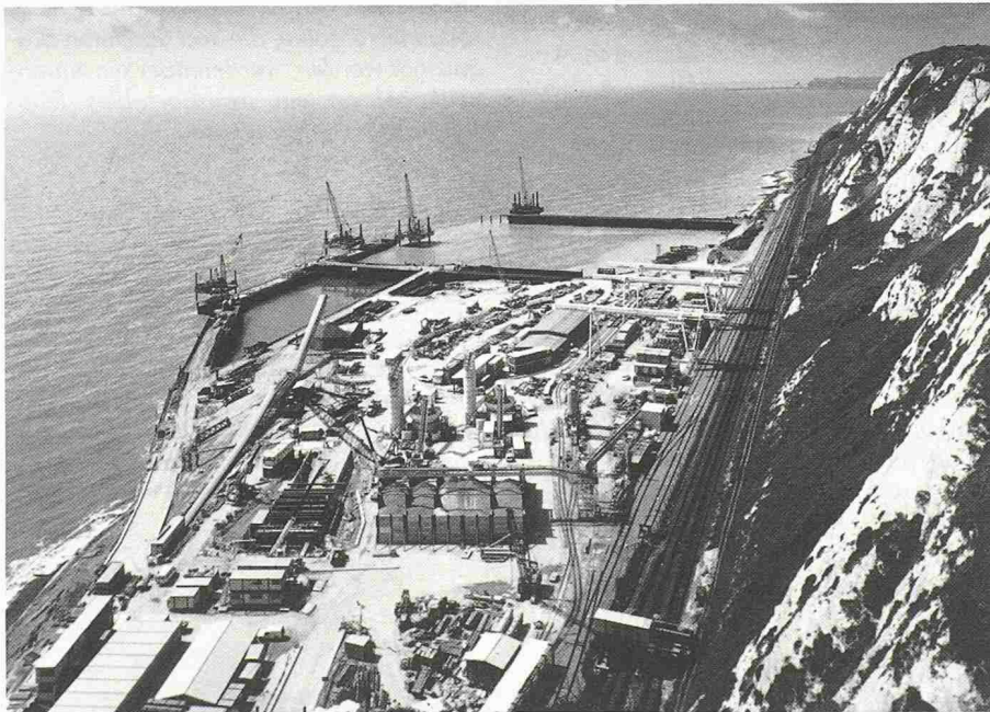
Die Küstenlinie Grossbritanniens wird sich leicht verändern: In der Nähe von Folkestone, Südengland, entstehen neue Strandmauern. Die dahinter liegenden Becken werden mit dem Aushubmaterial des Ärmelkanaltunnels aufgefüllt (Bild: LPS)
