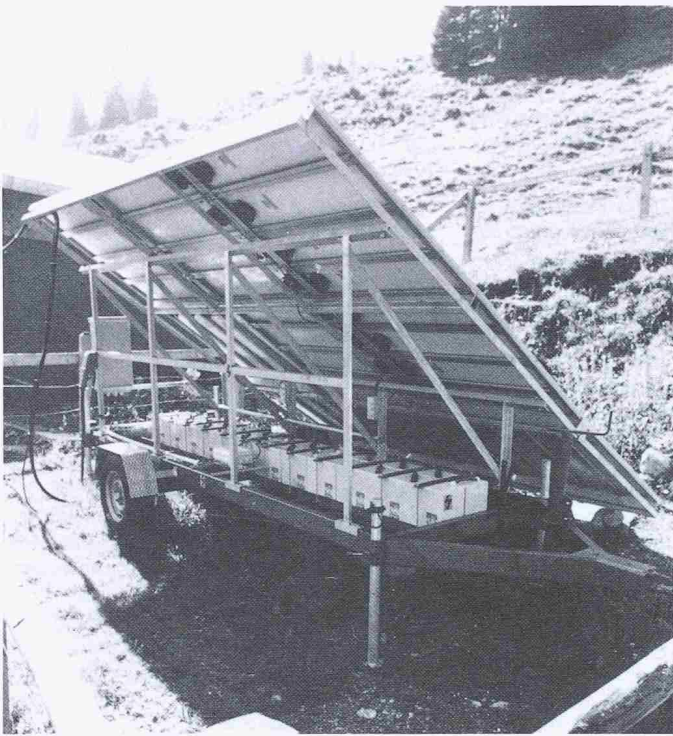
Bild 1. Die mobile Solarstromanlage ist auf einem einachsigen Anhänger aufgebaut. Der Anstellwinkel der Module ist auf 45° fixiert
