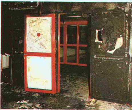
Brandfall im Donaucenter Wien, Lt. Löschericht der Wiener Feuerwehr dauerte der Brand 2 3/4 Stunden, wobei Spitzentemperaturen von 1400 C erreicht wurden. Ing. Carl Novak stellt fest, dass die Türen-/Rahmenkonstruktion funktionsfähig geblieben sind und nicht ersetzt werden mussten.
