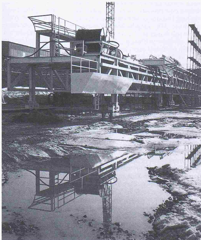
Bild 2 zeigt die Startgrube mit der Montageplattform für die über 1000 t schwere sowie 12,5 m lange Vortriebsmaschine
