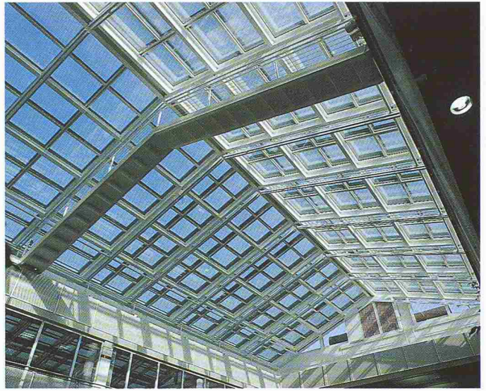
Die gesamte Glashaut kann zur Reinigung geöffnet werden. Durch Ausbildung ähnlich dem Kalt-Fassadensystem konnte die Schalldämmung noch wesentlich verbessert werden
