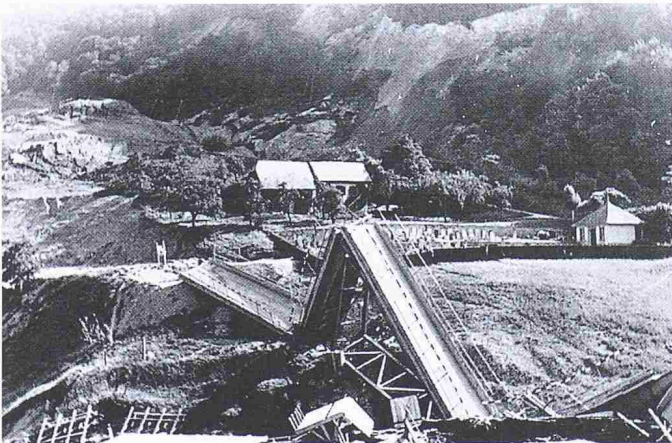
Bild 1. Rutsch Eptingen: Durch Erdrutsch zerstörte Dienstbrücke anlässlich des Baus der N2
