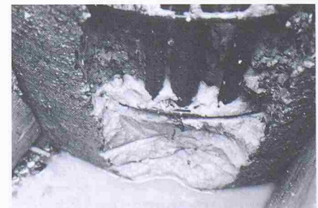
Bild 6. Detailaufnahme der Schadenstelle; ein Messrohr, zwei Stäbe der Biegebewehrung und die Spiralarmierung sind sichtbar
