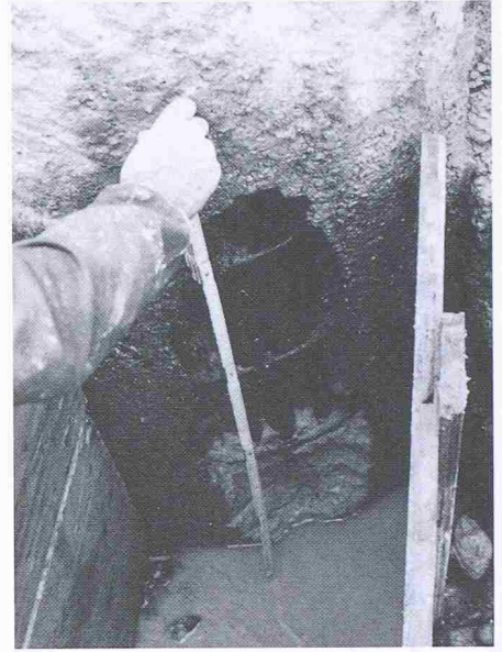
Bild 5. Der Schaden ist ziemlich gross
