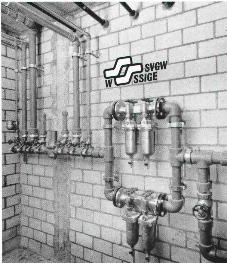
Verteilerbatterie in der Mövenpick-Raststätte «Heidiland» bei Sargans
