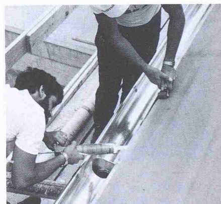
Durch Verschweissung oder Verklebung der Sarnatex-Unterdachbahn auf die Einlaufbleche werden die Traufanschlüsse rückstausicher ausgeführt
