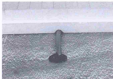
Gemäss Norm SIA 238 müssen Elektroleitungen raumseitig der Luftdichtungsschicht angeordnet werden. Dieses Elektro-Lehrrohr ist über der Dampfsperre und Luftdichtigkeitsschicht verlegt und durchdringt diese. Die Dampfsperre muss an das durchdringende Elektro-Lehrrohr luftdicht angeschlossen werden
