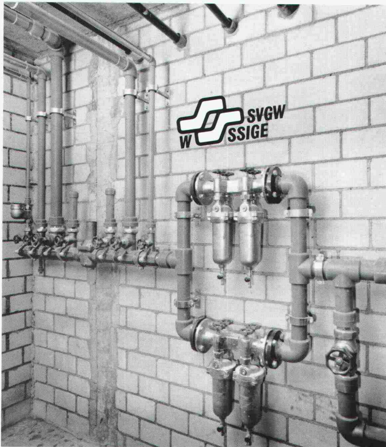
Verteilerbatterie in der Mövenpick-Raststätte «Heidiland» bei Sargans
