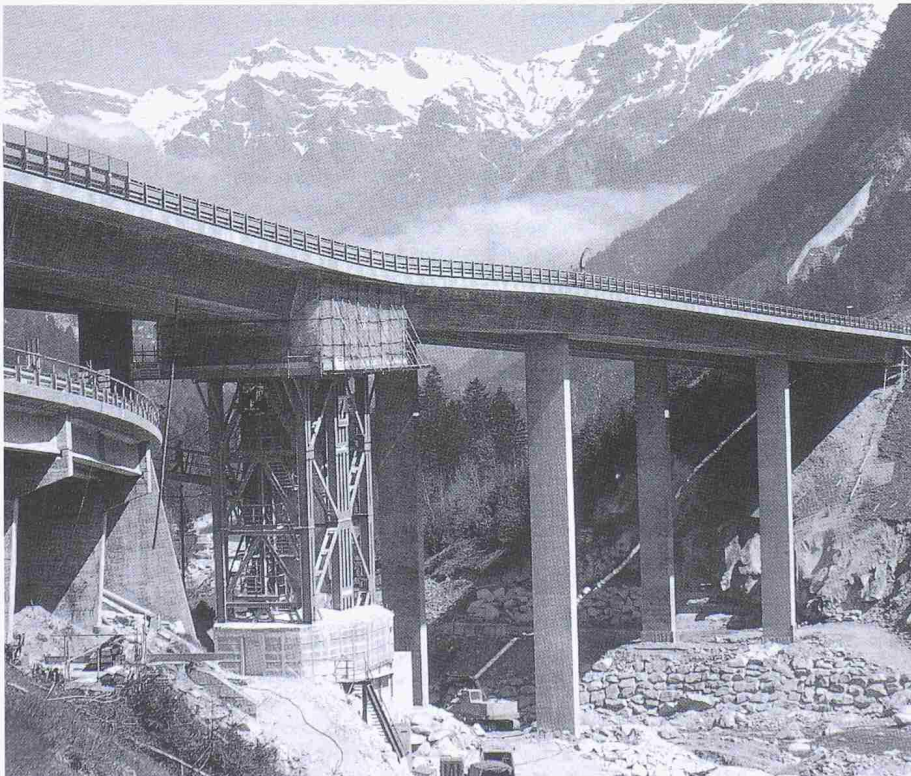
Wiederinstandstellung der Brücke Wassen der Gotthard-Autobahn N2 nach der Hochwasserkatastrophe 1987 – ein aufwendiges Rekonstruktionsobjekt von verkehrspolitisch grosser Bedeutung
