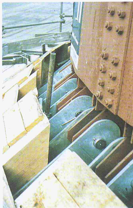
Bild 40. Der obere Anschluss nach der Montage. Die Gelenkbolzen sind mit Splinten gesichert
