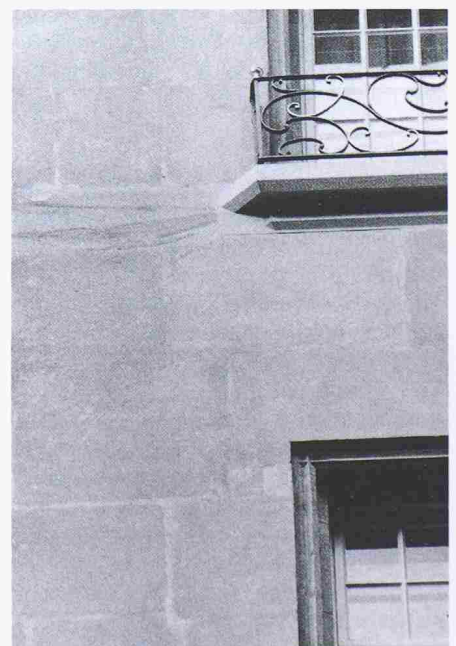
Bild 12. Ersetzte Fensterbank als Naturstein-Werkstück im Verband mit einer lediglich gereinigten, nicht überarbeiteten Fassade
