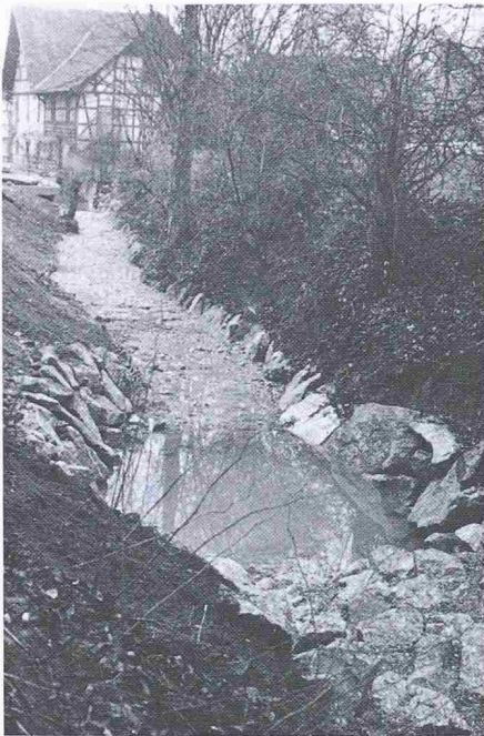
Bild 2. Blockrampe Mederbach Martha- len mit Fischgumpen, kurz nach der Fertigstellung Dezember 1984, Blick bachabwärts
