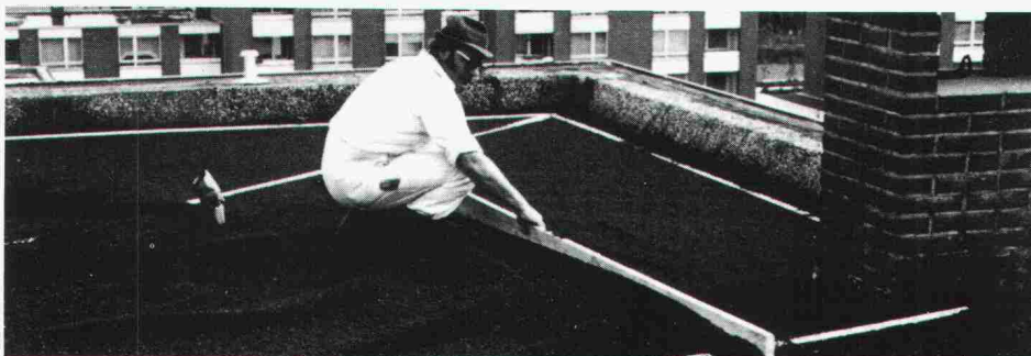
Das Material wird nach dem Anmischen mit Perlmix im gewünschten Gefälle über vorher ausgerichtete Lehren abgezogen. Nach dem Verdichten kann Thermoperl begangen werden.
