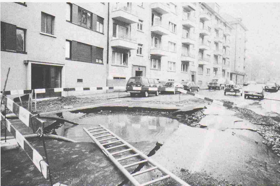
Bild 4. Strassenschäden infolge eines Wasserleitungsbruchs
