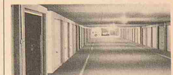
Doppelstock-Tiefgarage in der Überbauung Gramatt in Schübelbach SZ: Boxenmontage und Innenansicht
