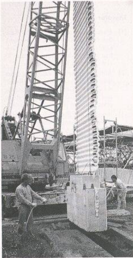
Bild 4. Mit einem Betonfertigteile beschwertes Gasmattelement vor dem Einbau in eine suspensionsgefüllte Schlitzwand
