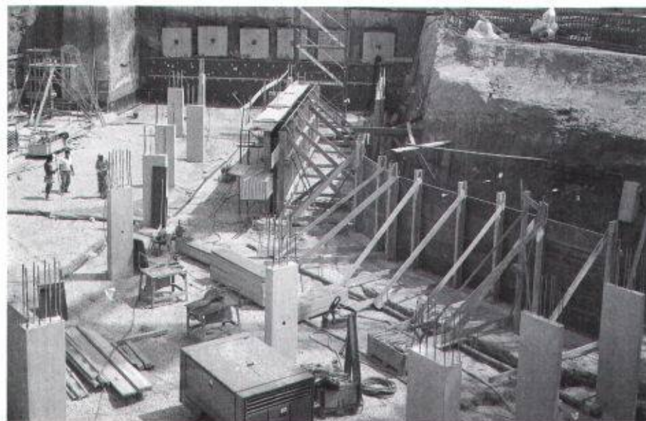
Applikation von Enkadrain CK direkt auf Molassefels (Generalunternehmung Promotion Bernard Nicod SA, Lausanne)
