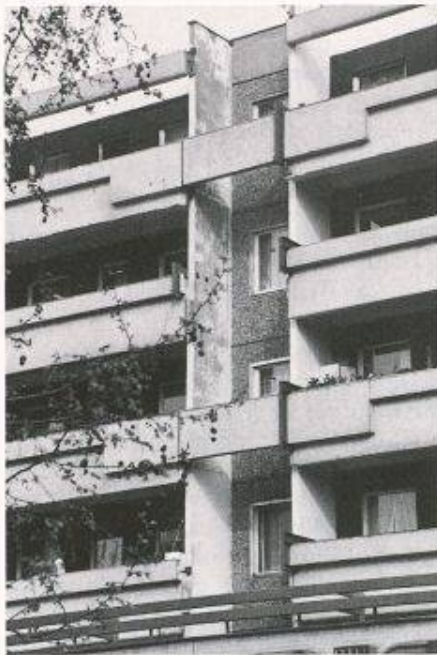
Bild 3. «Sozialistische» Neubauwohnungen – häufig ein lebensgefährlicher Pfusch! Nachdem bei diesem Wohnblock eine vorfabrizierte Balkonbrüstung in die Tiefe fiel und einen schweren Unfall verursachte, wurden die übrigen Brüstungen behelfsmässig mit Klammern und Überbrückungsplatten gesichert
