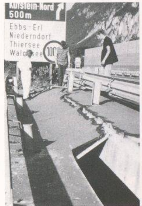
Bild 1. Inntalbrücke bei Kufstein nach dem Schadensfall
