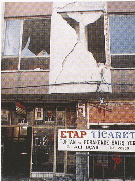
Bild 12. Dreigeschossiger Stahlbetonskelettbau mit Mauerwerk auf Deckenvorsprung. Mauerwerk mit X-Rissen, nicht als Ausfachung konzipiert
