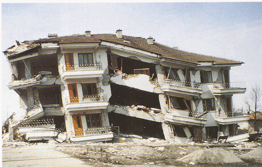
Bild 11. Stahlbetonskelettneubau mit Backsteinaufmachungen. Auffällig sind die Trennrisse und Betonzerstörungen in den Gelenkbereichen
