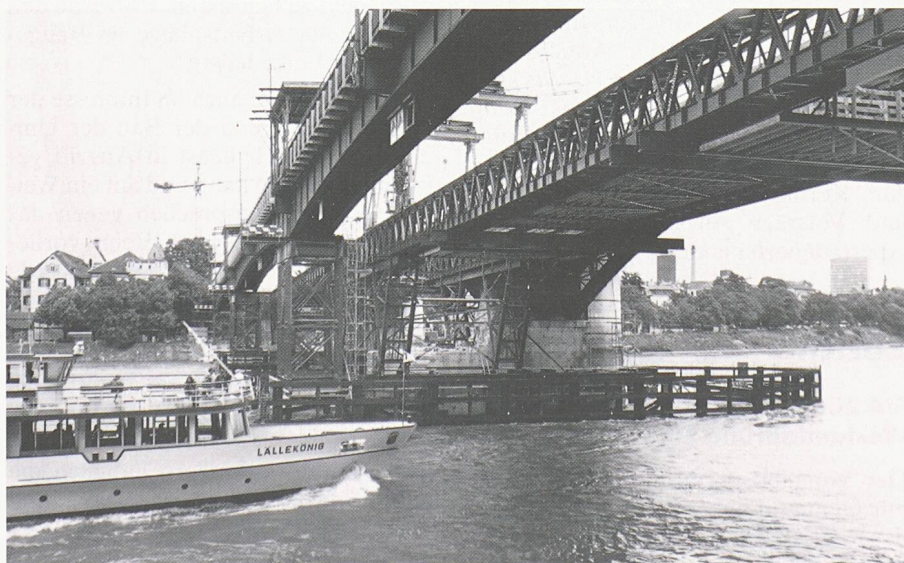
Die Hilfsbrücke links übernimmt während der Bauzeit der Basler Wettsteinbrücke den Autoverkehr. Deutlich sichtbar um den Brückenpfeiler: der Rammenschutz gegen Schiffs-kollisionen (Bild: Comet)
