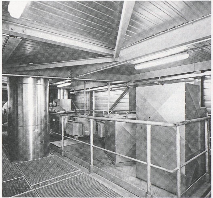
Bild 4. Oberer Teil des Elektrofilters mit Hochspannungsteil
