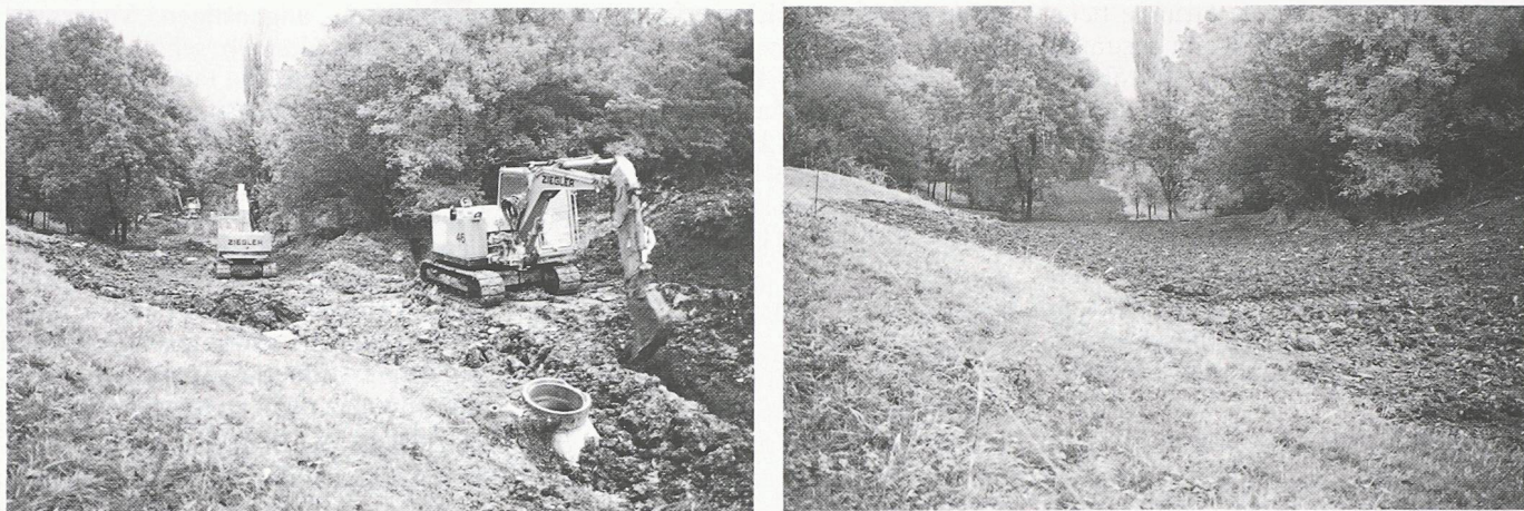
Bild 5. Beispiel Hinterer Wartenberg, Gemeinde MuttENZ: Arbeiten in schwierigem Gelände und schattigem, NE-exponiertem Hang (Bild 5a) unmittelbar nach der gelungenen Rekultivierung, die ein sorgfältiges Arbeiten mit der Moorraupe und einen erfahrenen Maschinisten erfordert (Bild 5b)
