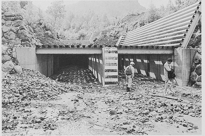
Bild 12. Murgangsbremse beim Kamikamihorizawa am Mount Yakedake
