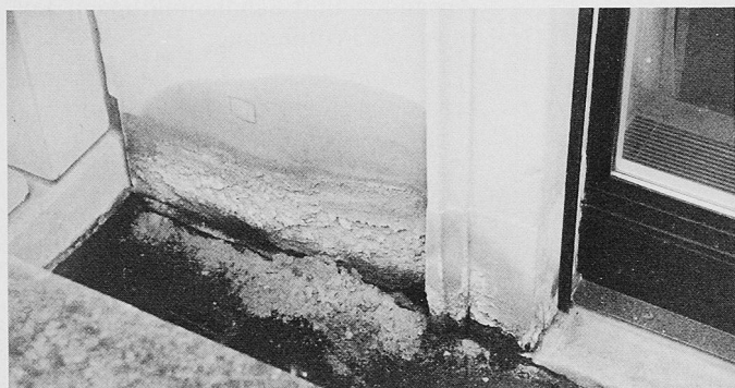
Bild 3. Schäden durch falsche Balkongefälle
