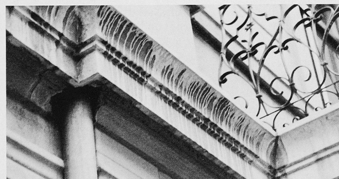
Bild 7. Kalkaussinterungen, unabgedeckte Gesimse
