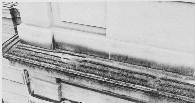
Bild 2. Schäden durch unabgedeckte Gesimse
