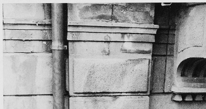
Bild 5. Schäden durch defekte Dachwasserrohre
