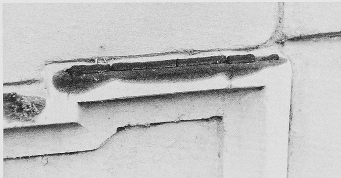
Bild 1. Schäden durch Taubenschutz-Pasten
