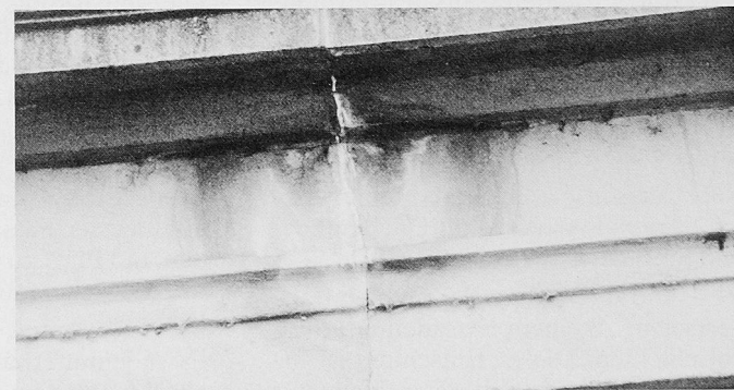
Bild 8. Schäden durch offene Fugen
