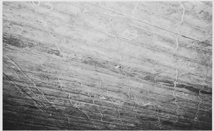
Bild 3. Risse an der Plattenunterseite
