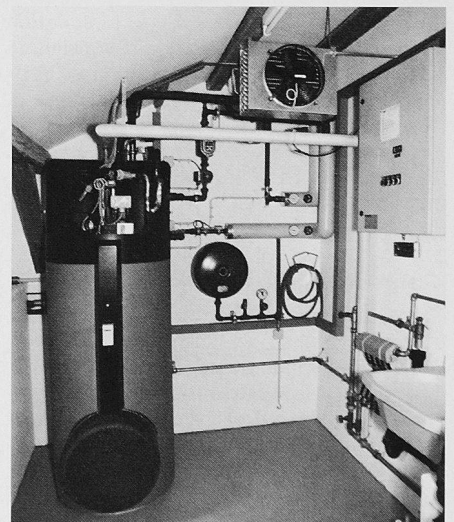
Die kompakte Wärmepumpen-Heizung im Dachgeschoss des alten Stöckli
