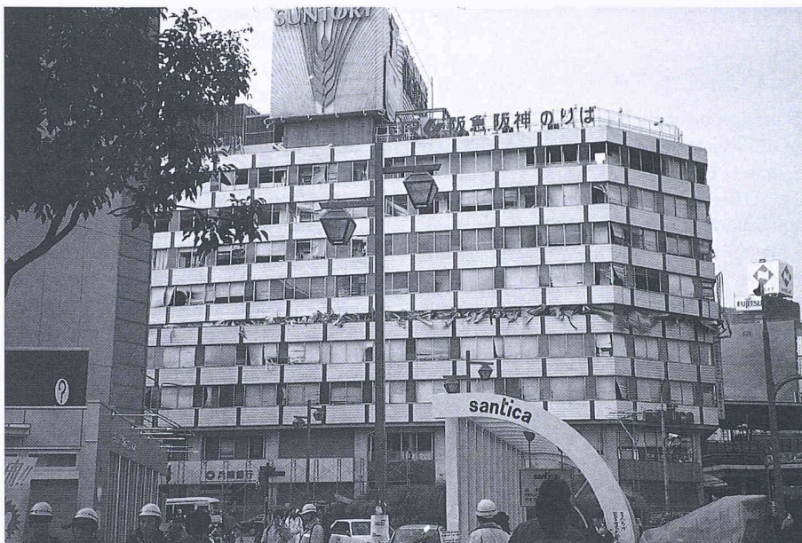
Bild 17. Geschäftshaus mit Mittelgeschosseinsturz
