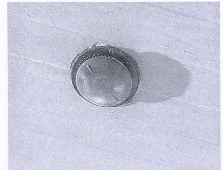
Bild 7. Kugelförmiger Luftauslass in der Küche (Beispiel Riehen)
