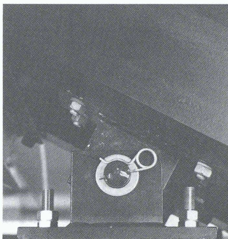
2a und b Kanalaufleger a) oberes drehbares Bolzenauflager und b) einseitig demontierbare Stütze mit Rohraufleger
