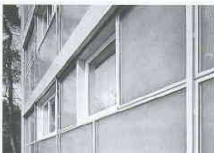
Die TWD-Platten wirken als Isolation und lassen dabei das Sonnenlicht durch. Sie sind direkt auf der Aussenwand montiert
