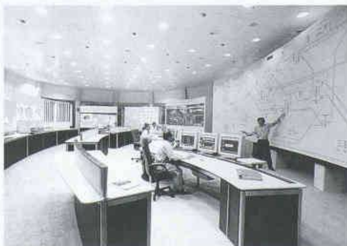
Herzstück des Neubaus ist der Kommandoraum der Energie- und Netzleitstelle. Hier wird rund um die Uhr das Stromversorgungsgebiet der NOK überwacht (Bilder: H. Krebs, Ottikon)
