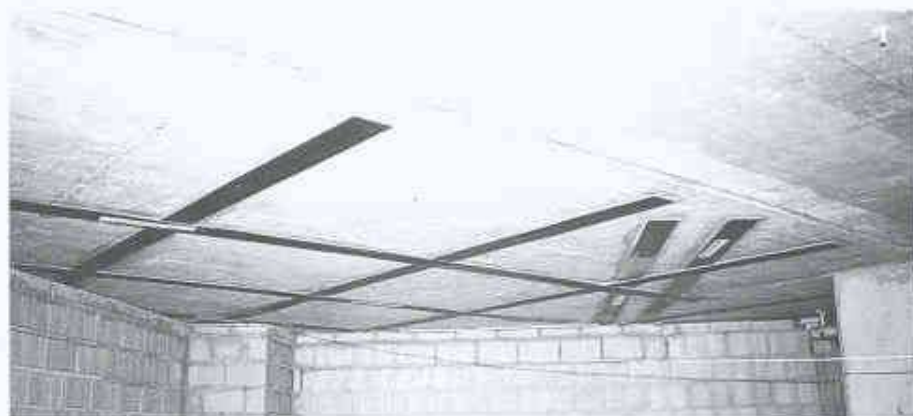
4 Verstärkte Stahlbetondecke mit dreifacher Lamellenkreuzung
