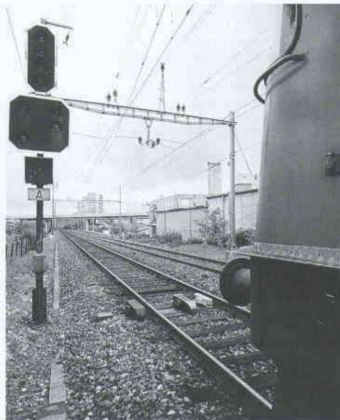
5 Gleisausrüstung für die Systeme Signum und ZUB
