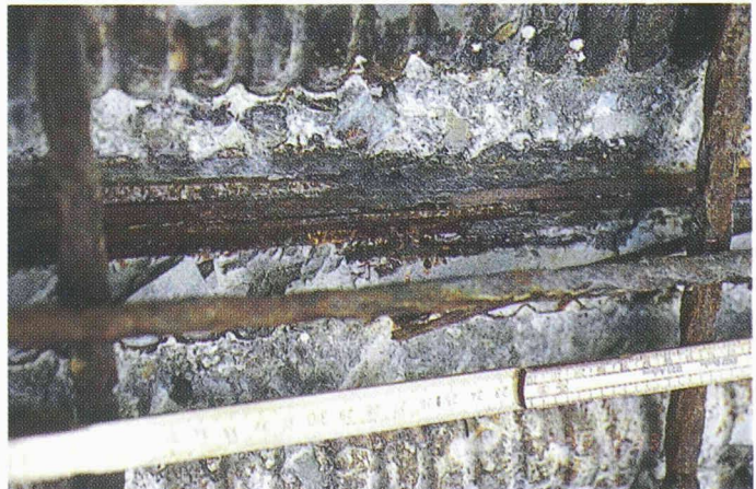
Belagsentlüftungsröhrchen (teilweise wasserführend)
