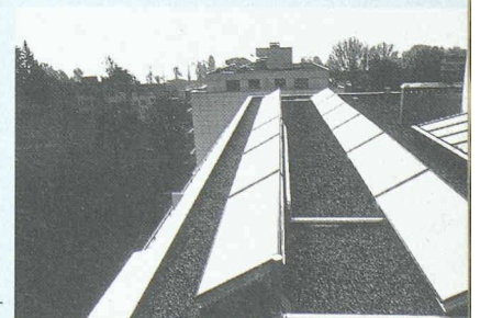
Diese Solaranlage auf einem Mehrfamilienhaus in Luzern wurde durch Contracting ermöglicht.
