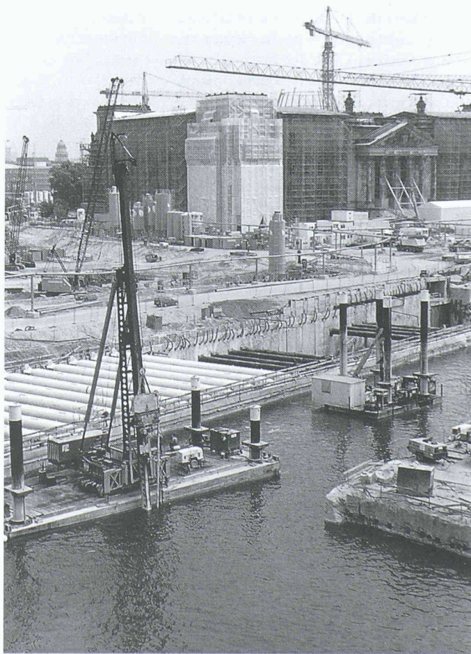
Blick vom Dach der Schweizer Botschaft. Im Vordergrund die Baugruben für die Tunnels (rechts geflutet, links trockengelegt), im Hintergrund das Reichstagsgebäude. Auf dessen Dach entsteht Norman Fosters Glaskuppel (Bilder: Daniel Kohler)
