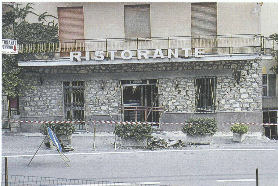
Hotel mit Restaurant: grobe X-förmige Risse in den kurzen Natursteinwänden im Erdgeschoss
