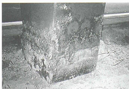
5 Zustand Mittelstützenfuss vor der Instandsetzung
