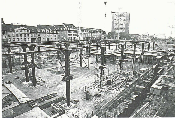
13 Hauptstützen im Untergeschoss mit Montageaussteifung
