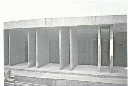
16 Randaufleger in den äusseren Gebäudeabschnitten. Biegeeweiche Konstruktion für die Längsrichtung aus 60 mm starken Lamellen aus FeE 460
