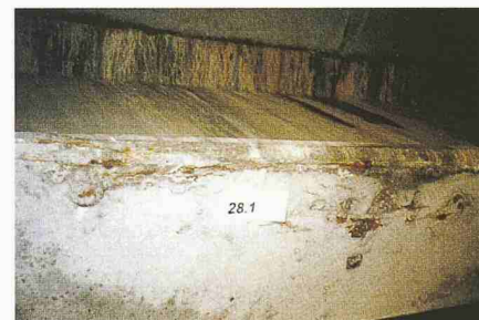
5 Schäden an Elementträger Nr. .1 und .5 (unten)
