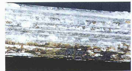
12 Korrosion an den aussen und unten liegenden Drähten
