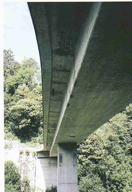
Talseitige Untersicht der Kragplatte und des Stegs mit Aussinterungen und Rostspuren unterhalb der Belagsentwässerungen
