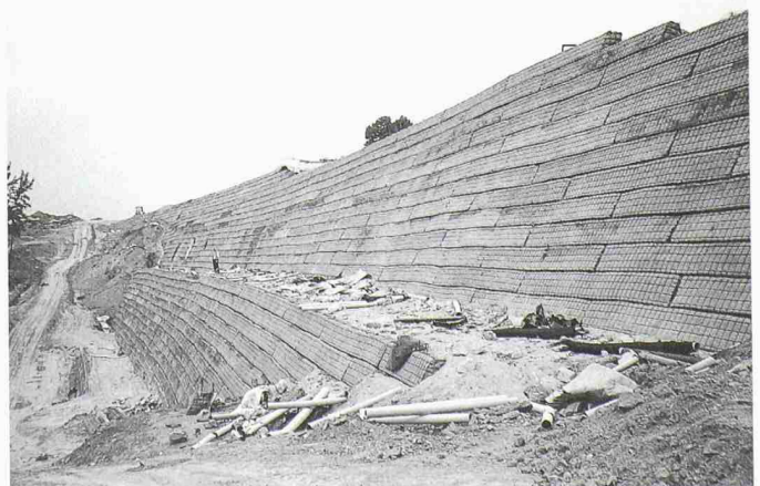
1 Ansicht der fertig erstellten Stützwand von 28 m Höhe an der Autobahn bei Ponferrada, Spanien
