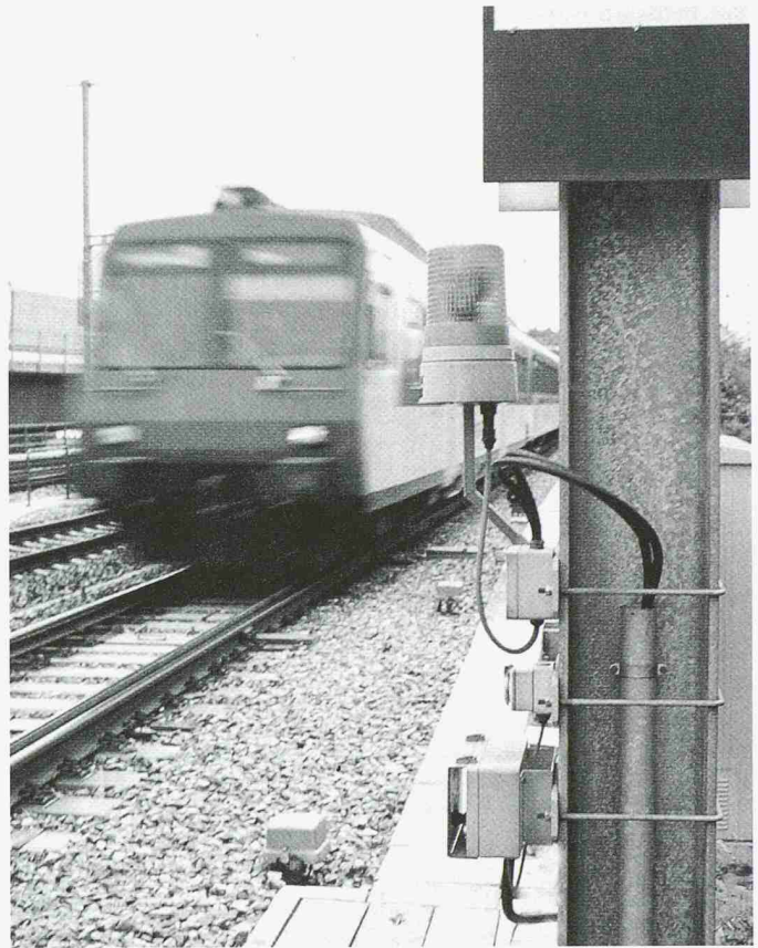
5 Warnmittel und Bedienstelle montiert an Fahrleitungsmast, im Hintergrund PWA-Steuerschrank
